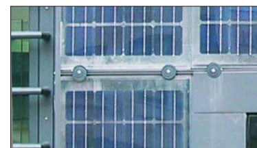
Solcellepanelerne er monteret med enkle, mørke clamps.
