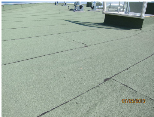
Dampbuler i tagpapbelægning på tag.
