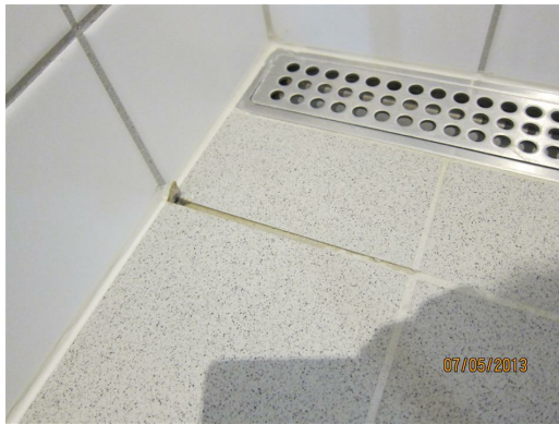
Foto af svigt i mørtelfuge i flisegulv. Lejlighed 29-5.tv.
