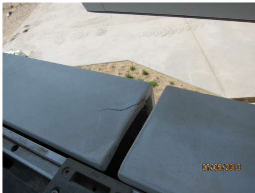
Revne i sålbænk af fibercement. Lejlighed 33-st.th.
