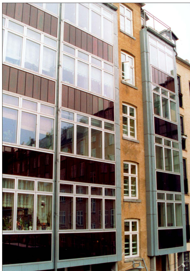
På gårdfacadens glastilbygninger ses solcellepanelerne i brystningerne.
